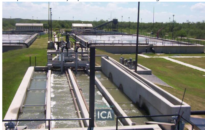
Ilustración 14. Canales de pretratamiento y reparto a tratamiento biológico de la PTAR Acuña.
