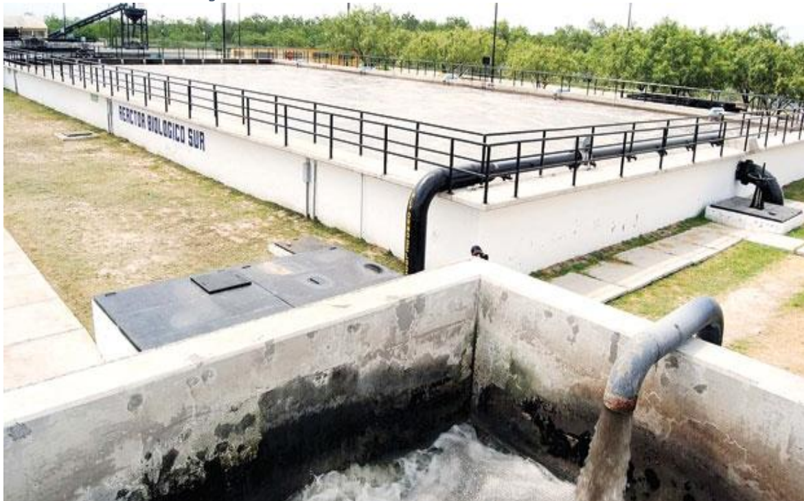
Ilustración 11. Reactor Biológico Sur de la PTAR de Ciudad Acuña.
