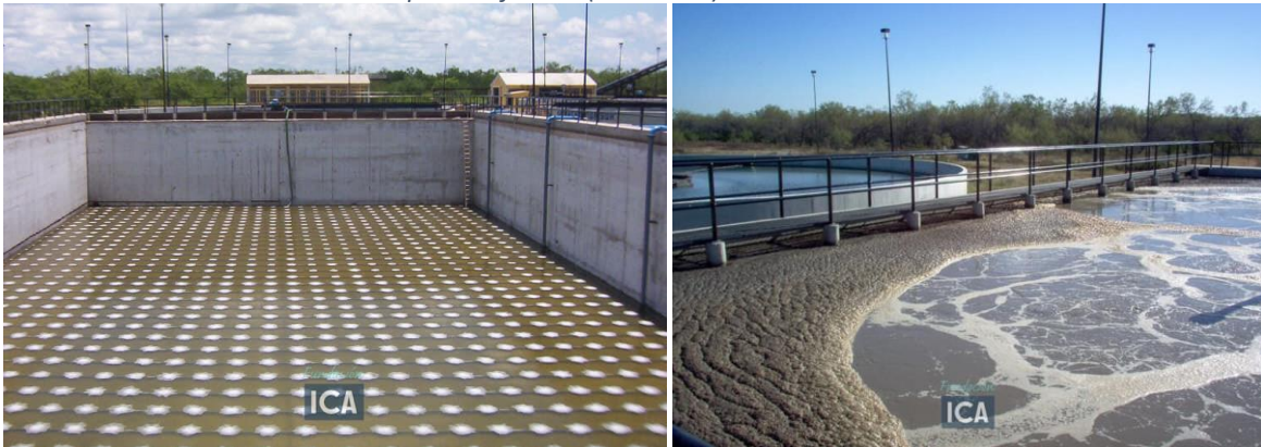
Ilustración 13. Parrilla de aireación por insuflación (extendida) de la PTAR Acuña.
